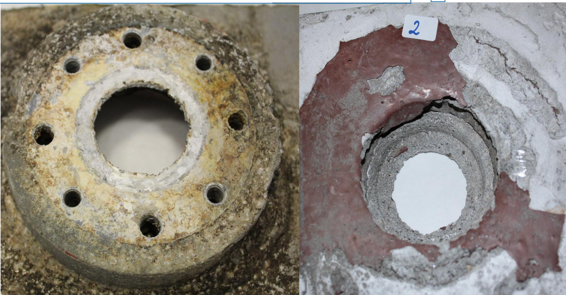
korrodierte Tankausläufe bei alten ALU-Tanks
